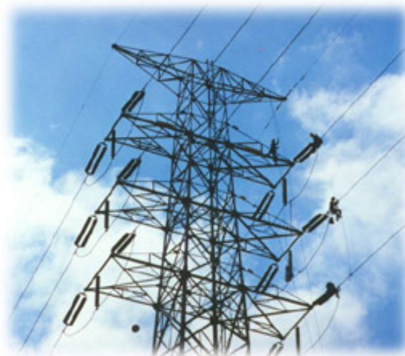
Figura I-8: Torre de alta tensão
