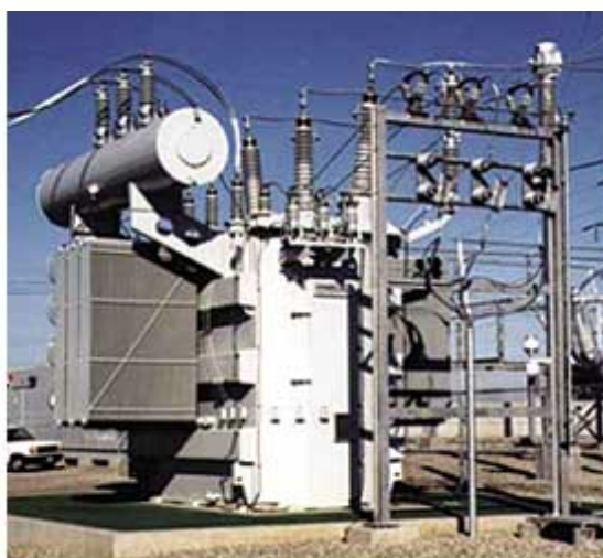
Figura I-15: Transformador em uma subestação
