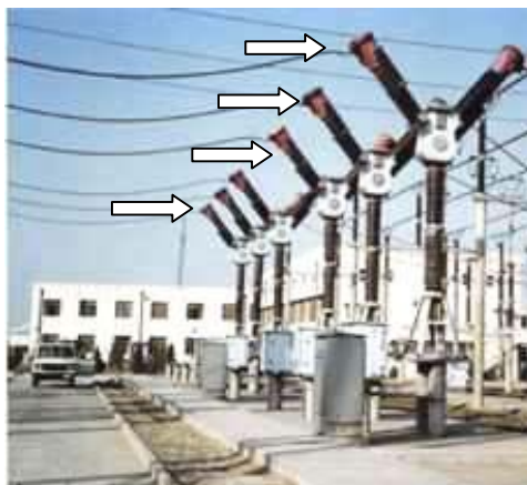
Figura I-7: Disjuntores a gás
